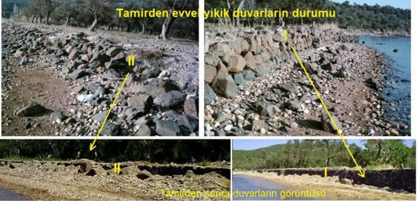
Foto- F-1. Mevcut duvarın zamanla şiddetli dalgaların yıktığı zeytinlik kıyısı duvarın sağlamlaştırılarak tamiri nedeniyle Ayvalık Belediyesi tarafından, iki sene hapis cezası ve yüklü ceza istemi ile yargılanırken aynı belediyenin Şekil 3 de denizi doldurması VE denize sıfır inşaat yapanların yer kazanmak, ve kolaylık olduğu için denizi doldurmalarına ses çıkarmamaları gerçek zihniyeti göstermektedir.
