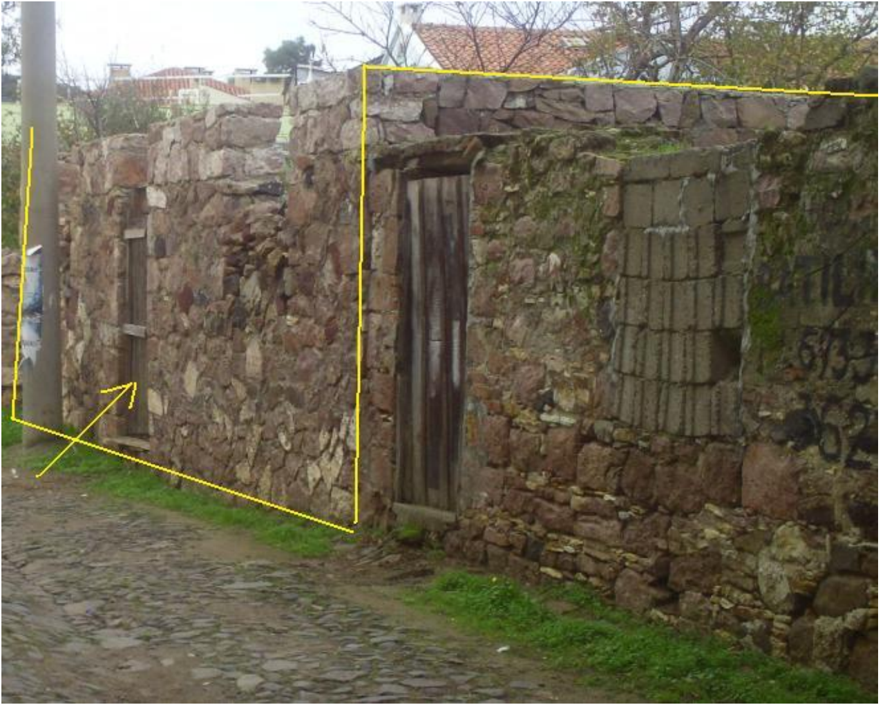
Foto D-3 yıkık binanın yoldan görünüşü. Okla işaretli duvarlar 1980 yılına kadar çok daha yüksekti. Burada bina çıkılmak üzere üzere duvarlar yıkılmıştı. Daha sonra öngörülen bina başka bir yerde ailevi nedenlerle yapılmıştı. Bu yıkılan duvarın yerine uzun süre tahtlarla korunmağa alınmıştı. Tahtaların sert rüzgarlarda iki de bir yıkılması, dışarıdan bilhassa çocukların bahçeye girmeleri üzerine iki sene önce burası taş duvarla sağlamlaştırılmıştır. Bunun üzerine Belediye yapmadığını bırakmadı, ,,,, (Belediyeden izin istemekte, imar durumun tekrar gözden geçirilmesi için müracaat edilmektedir, bu istemlerinize bırakın cevap verilmesi, görüşme talebini dahi ret ediyor. Bizde duvarı çıkmaya başlayınca mahkemeye para ve hapis cezası istemi ile baş vuruyor.
